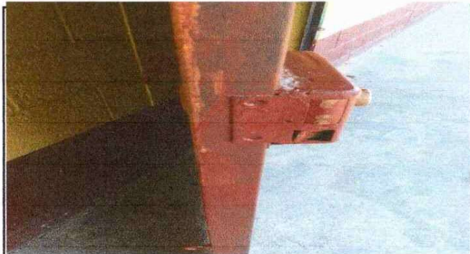
Foto 3: se observa el deterioro de las chapas de las puertas
