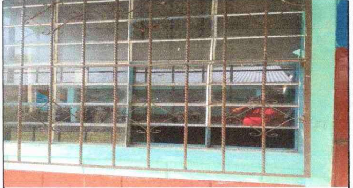
Foto 2: se observa los daños en los vidrios y los balcones
